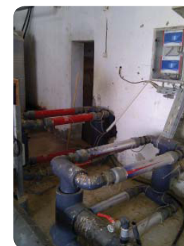
Installation Aqua-4D ® pour une serre de 20ha en Tunisie
